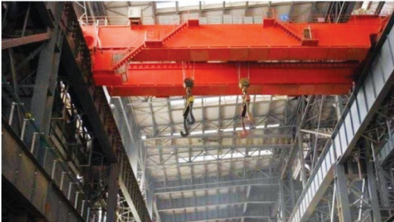
รูปที่ 1 เครนไฟฟ้าเหนือศีรษะ (Electric Overhead Traveling Crane) [8]
