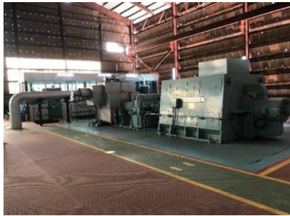
รูปที่ 3 กังหันขับเคลื่อนเครื่องกำเนิดไฟฟ้าขนาด 9 เมกะวัตต์
