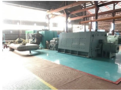
รูปที่ 4 กังหันขับเคลื่อนเครื่องกำเนิดไฟฟ้าขนาด 12 เมกะวัตต์
