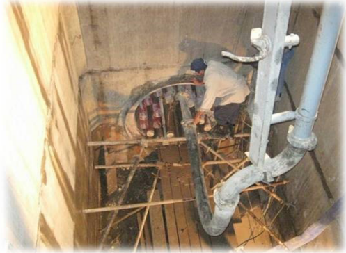
รูปที่ 6 การอัดด้วยคอนกรีตเหลวด้วยวิธีอัดแรงดันสูงภายในท่อร้อยสายไฟฟ้าใต้ดิน
