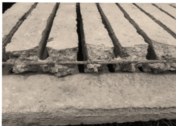
(ค) ความเสียหายแผ่นพื้นคอนกรีตเสริมเหล็ก รูปที่ 1 แผ่นพื้นคอนกรีตในโรงเลี้ยงสุกรในประเทศไทย
