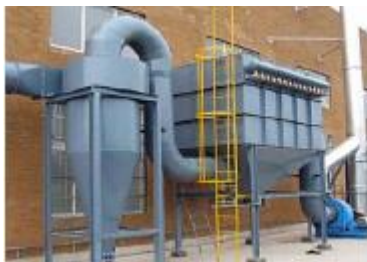
ระบบดักจับฝุ่น
