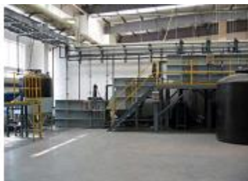
ระบบบำบัดน้ำเสีย
