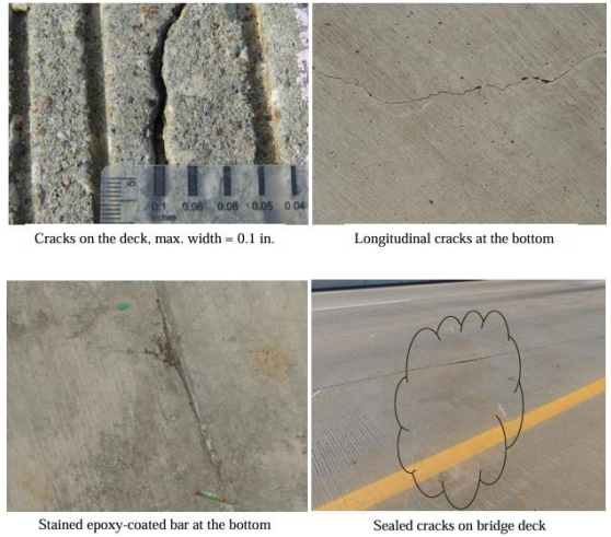
รูปที่ 1 ความเสียหายของพื้นสะพาน
